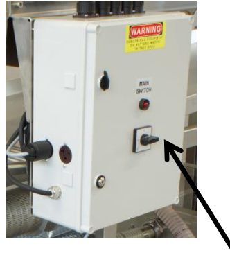
Фото 22. Коробка питания оборудования с главным выключателем
