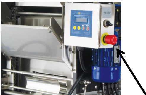
Фото 21 Аварийная кнопка СТОП
